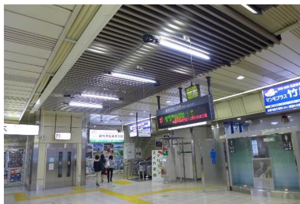
JR 前橋駅コンコースに設置された天井冷房システム
