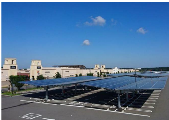
駐車場太陽光 (ソーラーカーポート)
